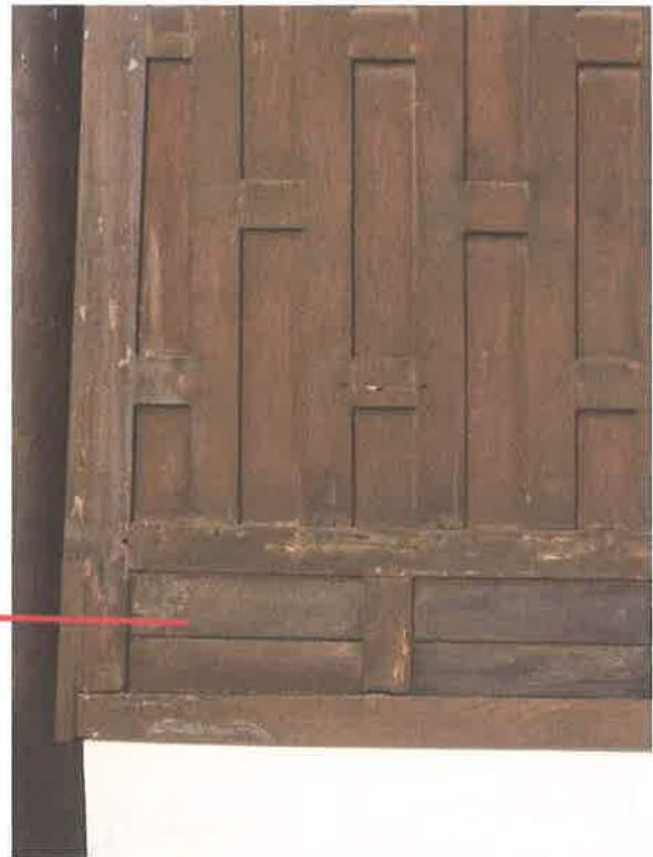
ฝาที่ 1 ลูกฟักกลางเสียหายจนแผ่นไม้หลุดออกจากกันตลอดแนว จำเป็นต้องถอดยกออกไปซ่อมแซมที่โรงงาน
